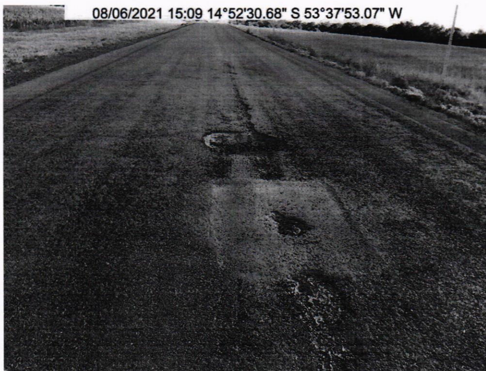
FOTO 13: BURACOS NA REGIÃO DO EIXO- km 7,8
