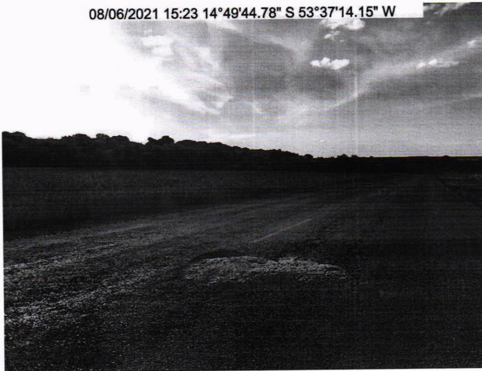
FOTO 5: NECESSIDADE DE REPARO - km 2,1
