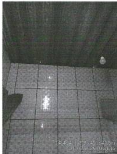
Figura 10: Ausência de forro no banheiro
