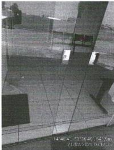
Figura 9: Porta de entrada com defeito
