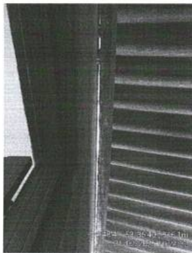
Figura 11: Ausência de rufo na lavanderia
