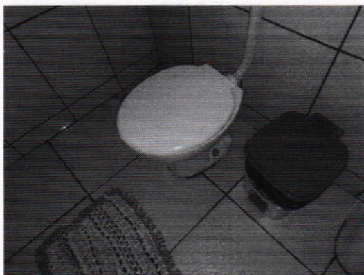
Figura 03 – Vaso Sanitário solto
