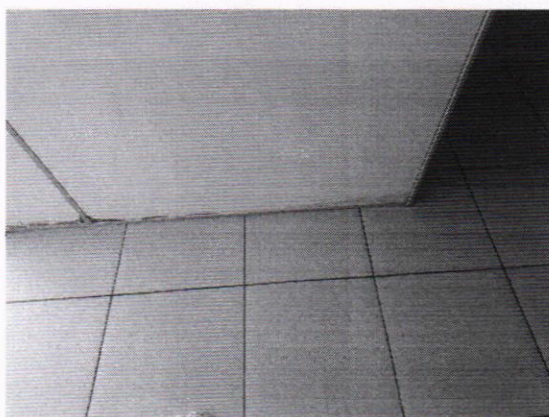
Figura 05 – Deterioração das divisórias pela umidade
